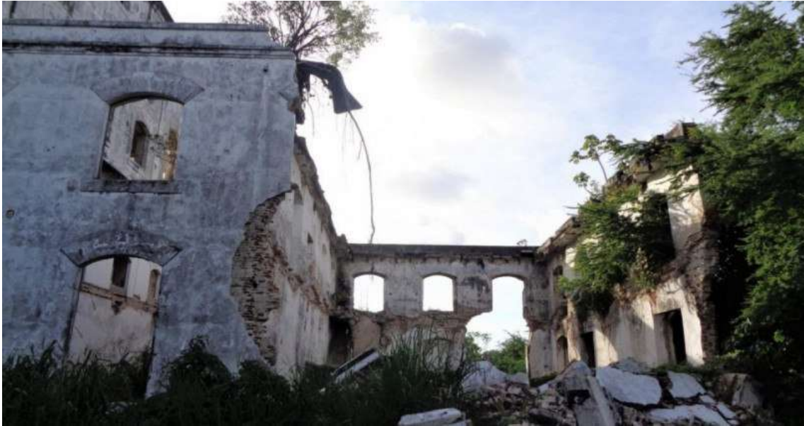
Figura 2 Desabamento de paredes, danos provocados por roubos de esquadrias, lajes, pilares e cobertura
