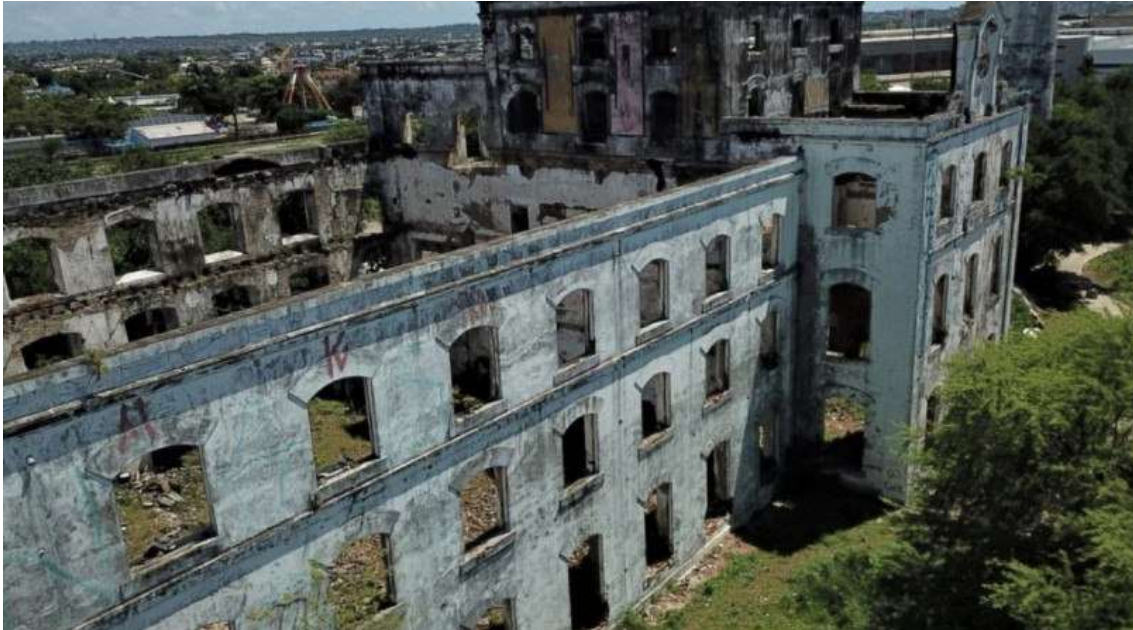
Figura 4 Desabamento de paredes provocados por pichações, roubo de esquadrias, lajes, pilares e coberta. Fonte: https://jc.ne10.uol.com.br/colunas/jamildo/2023/05/15472962-tce-diz-que-gestao-paulo-camara-deixou-fabrica-tacaruna-sob-risco-iminente-de-desabamento.html
