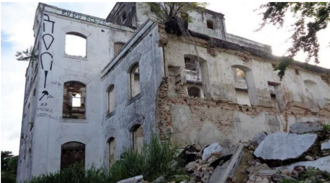
Figura 3 Desabamento de paredes, danos provocados por vegetação aérea, pichações, roubo de esquadrias, lajes, pilares e cobertura.
